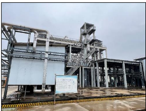
污水处理站预处理设施-湿式氧化
