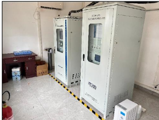
RTO 焚烧系统-烟气在线监测设施
