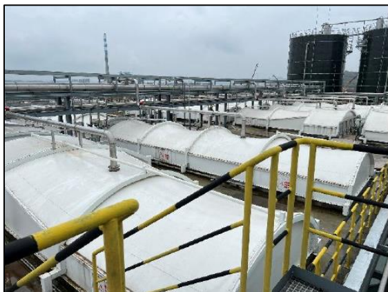
污水处理设施-生化段密封现状
