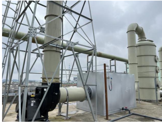
污水站生化段废气治理设施
