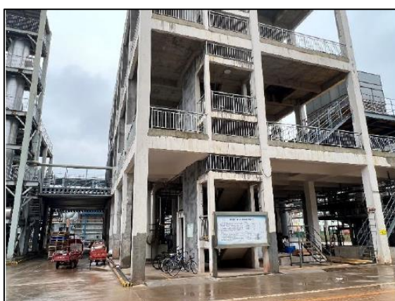
污水处理站预处理设施-MVR
